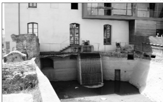
Einlassrechen der Turbine der Farinera bei abgelassenem Stauteich
